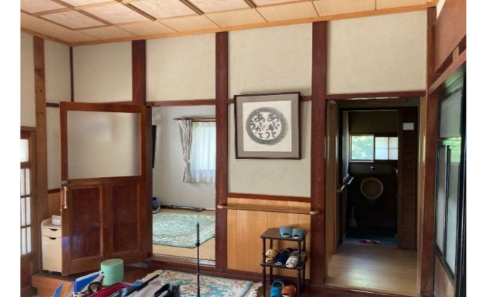
トイレへ行く時の開口幅は745mmと狭い。和室⑤の開きドアも危ない。 ホール①～和室⑤段差:110mm
