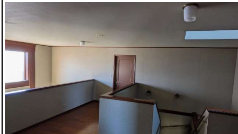
2階ホール改修前 吹抜け窓からの採光が腰壁によって、はっきりと影ができ、暗い。
